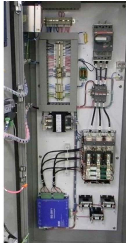
Gabinete AVC trifásico típico
